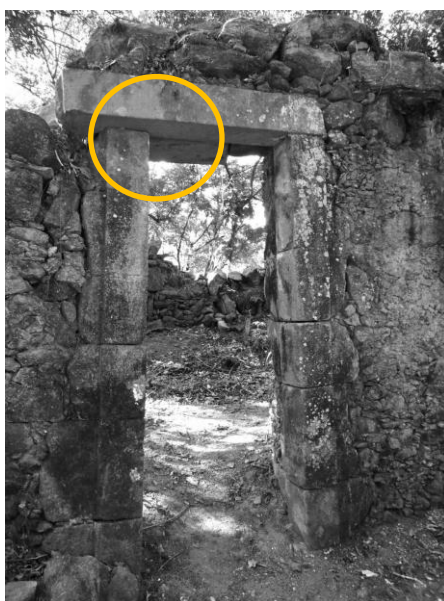
Exemplo de fragilidade da estrutura em CQ / C
