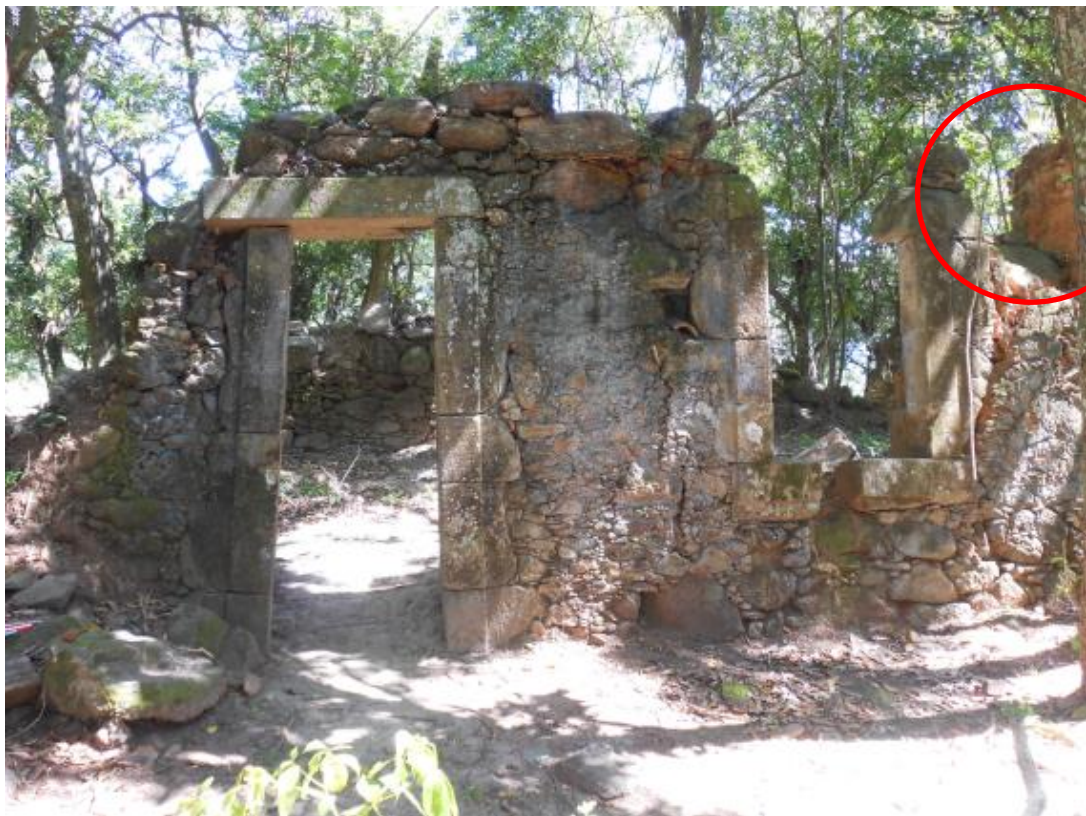
Exemplo de registro de desmoronamento em CQ / C
