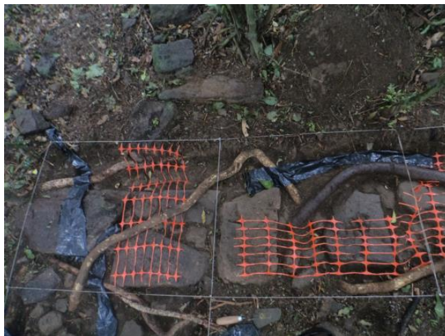
Exemplo de sinalização em CML2 / T1
